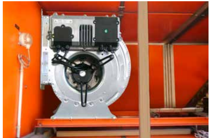
Neu rund 70% Leistungswirkungsgrad, ca. 40% Energieeinsparung und keine Wartungskosten mehr.
